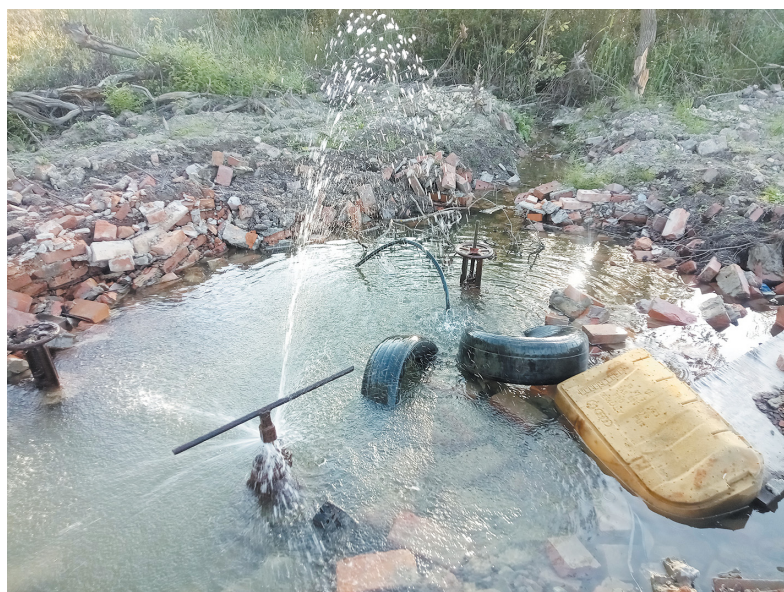
Место прорыва магистрального водопровода на улице Шишова
